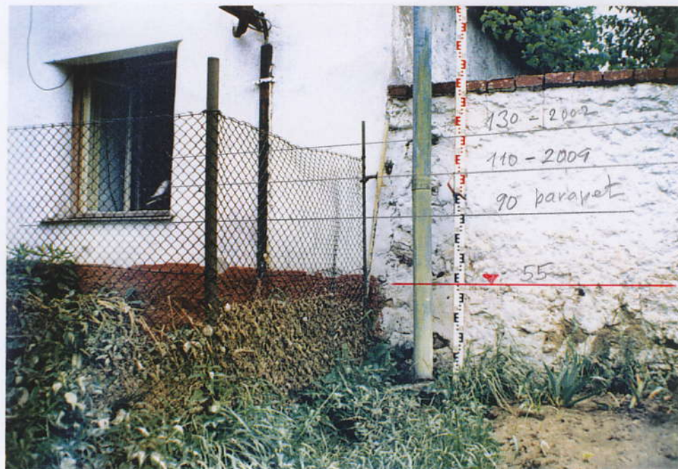
Kulminační výška hladiny u domku v sousedství mostu ve Sviněticích (54 cm na nivelační lati)
