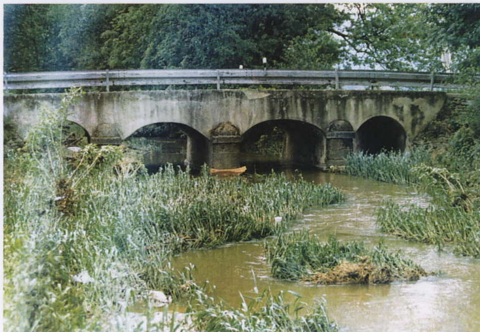
Most přes Bílský potok v obci Svinětica, za kulminace zahlcen bez výraznějších stop přetékání
