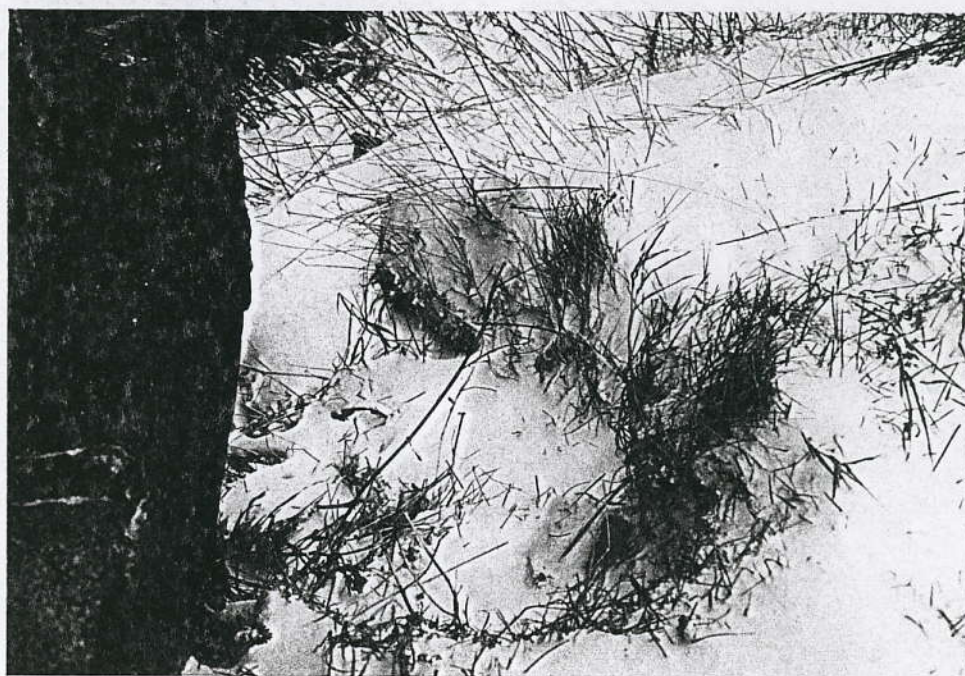
Most přes Řásnici u obce Hliniště 1 den po kulminaci, o jeho zahlcení svědčí výmol v místě označeném na horní fotografii šipkou, na dolním snímku je zachycen detail téhož místa.
