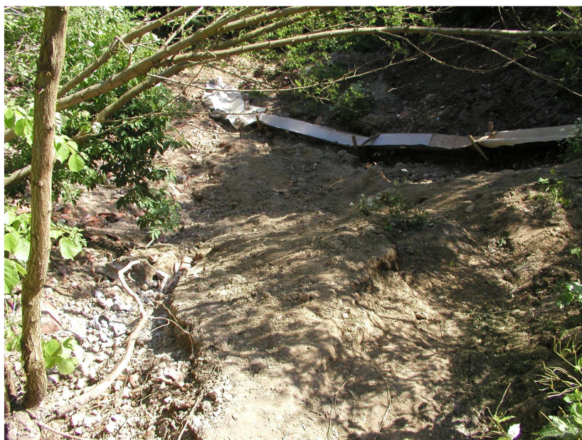
Foto 13: Horní část sesuvu těsně pod zdí kláštera
