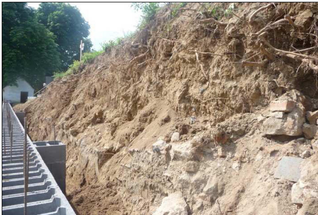
Foto 31: Materiál sesuvu se zbytky obvodové zdi
