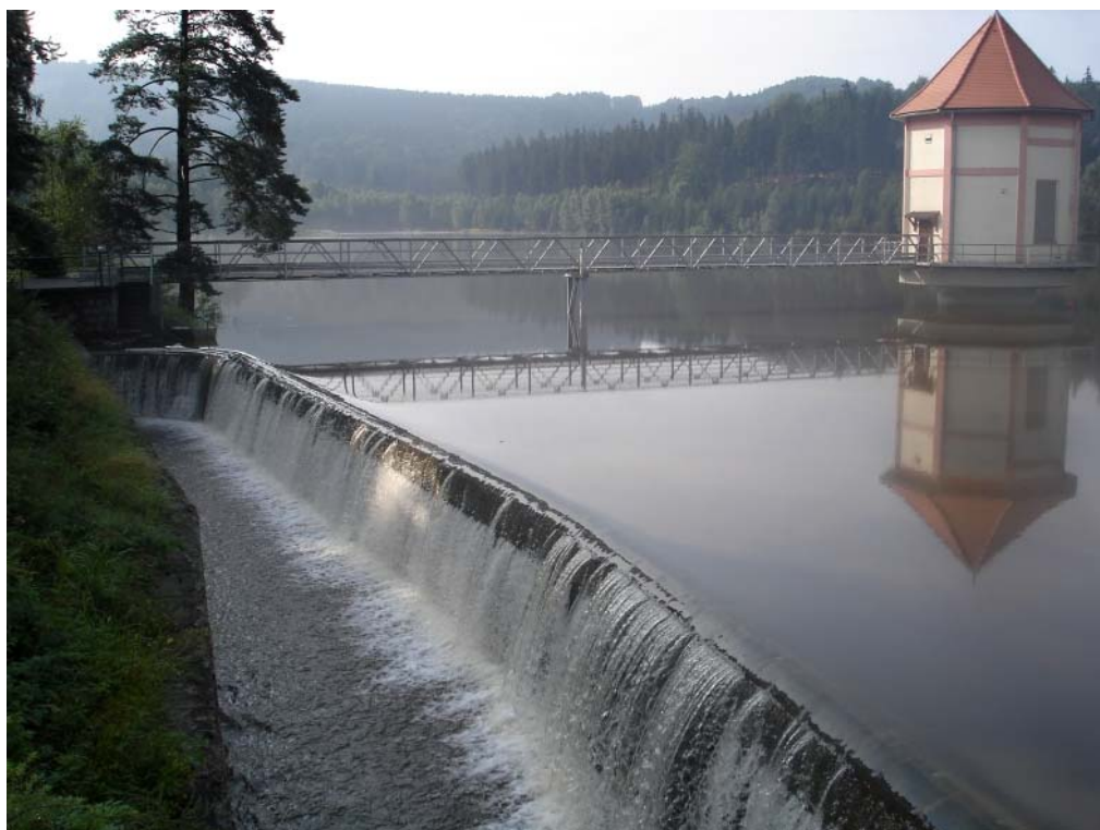
Obr. 2.10 - VD Chřibská, přepad přes bezpečnostní přeliv dne 8.8.2010
