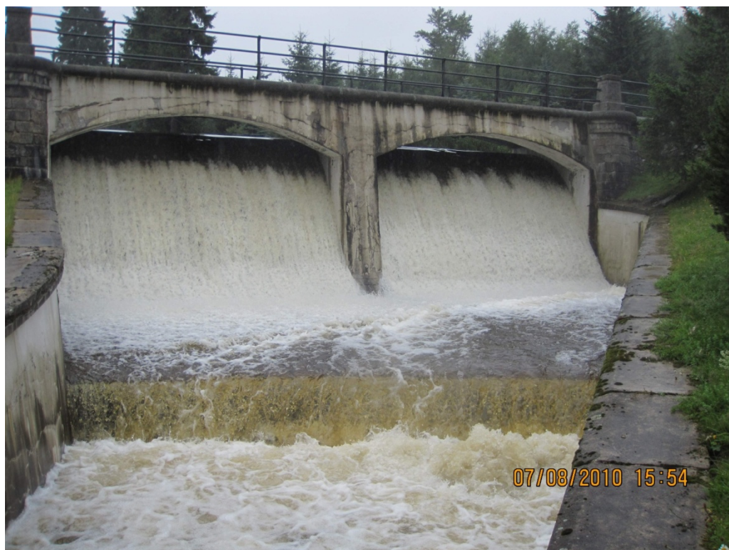
Obr. 2.8 -VD Bedřichov, bezpečnostní přeliv při povodni
