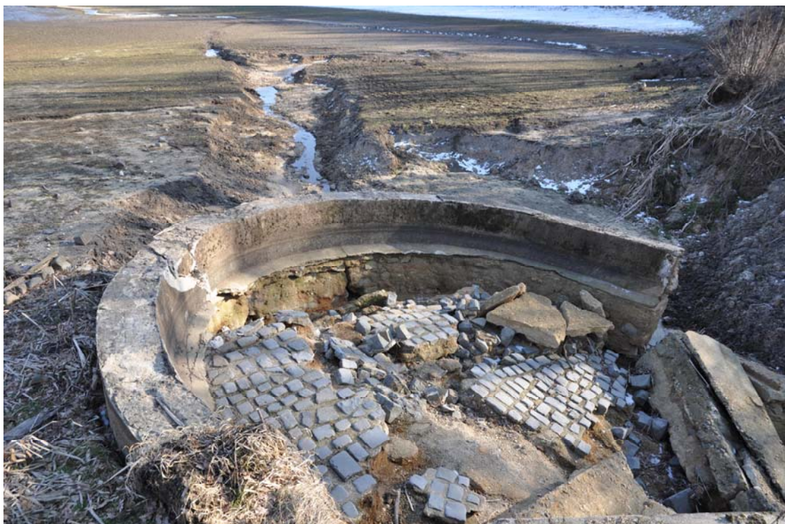
Obr. 3.36 – Panenský rybník – pohled na zničený bezpečnostní přeliv
