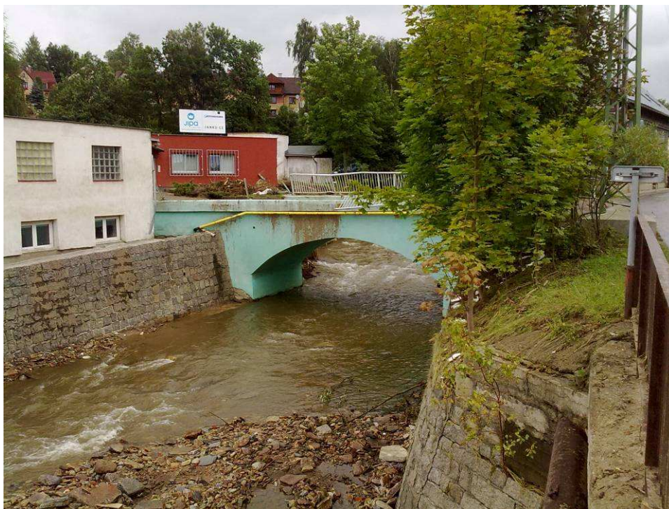
Foto 4.6 Klenbový most v Chrastavě se zničeným zábradlím
