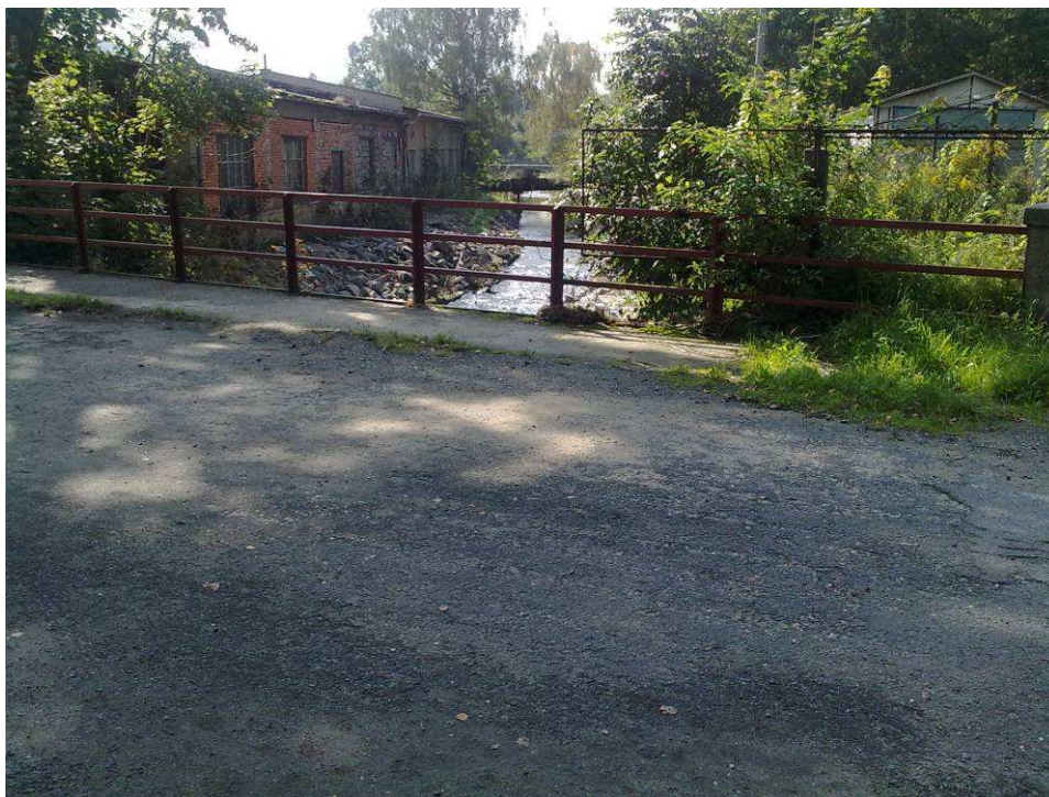
Foto 10.3 Stopa na zábradlí po přeléváního mostu v ř.km 0.574
